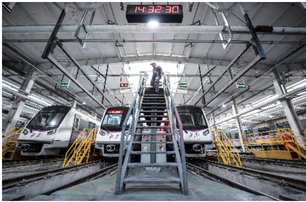
列车一字排开等待对空调系统最后的调试检验
