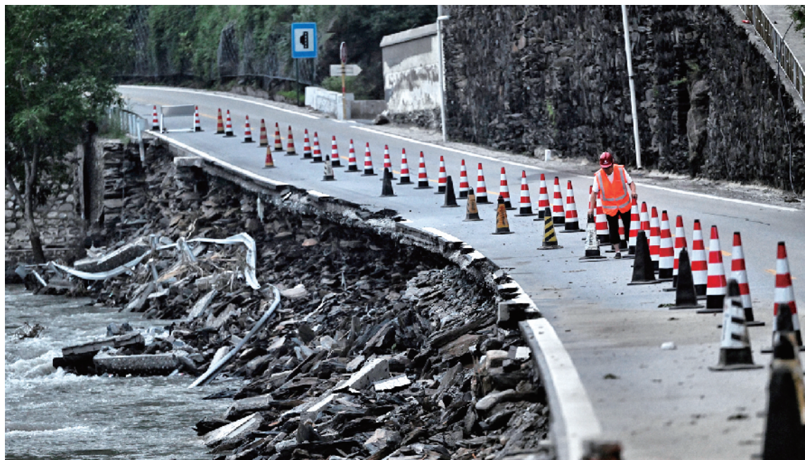
养护职工在塌陷的路面旁摆放警示路标
