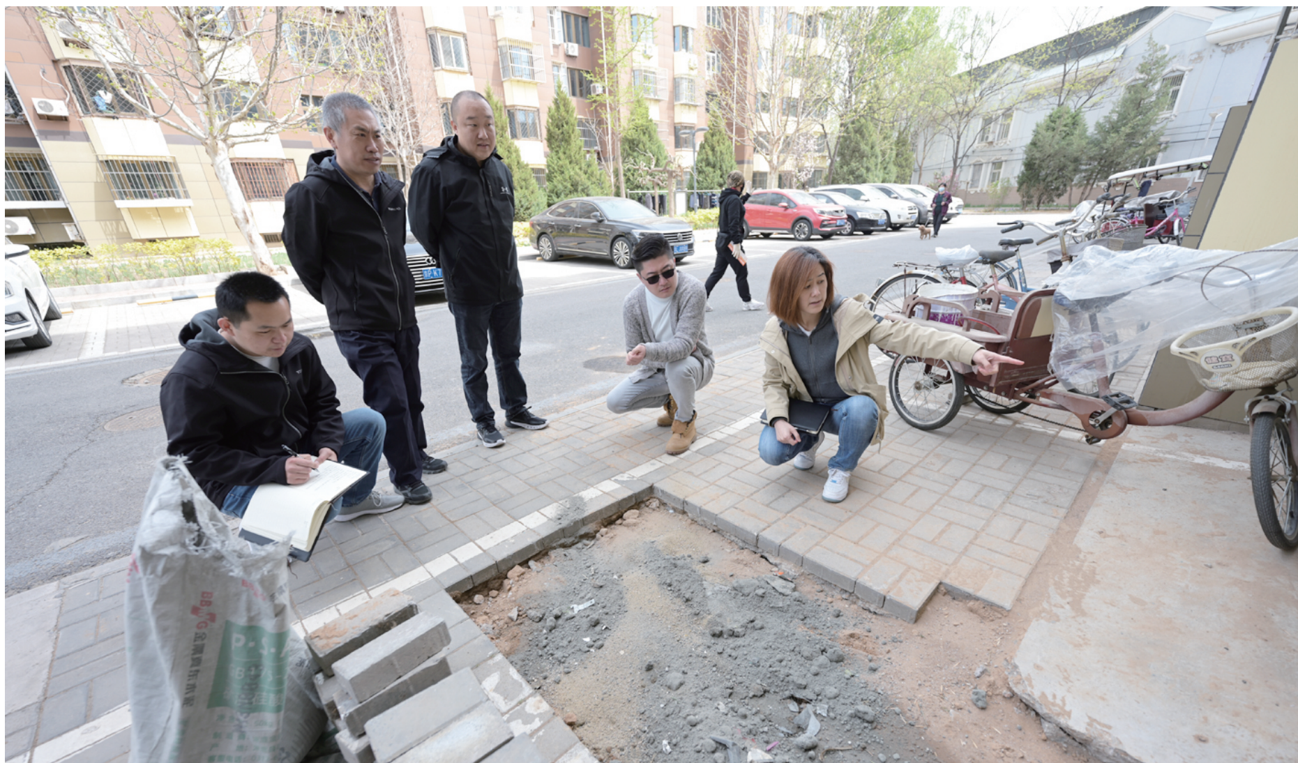
一户居民反映自家地下室漏水，侯莹（右一）带领工作人员即刻上门现场查看
