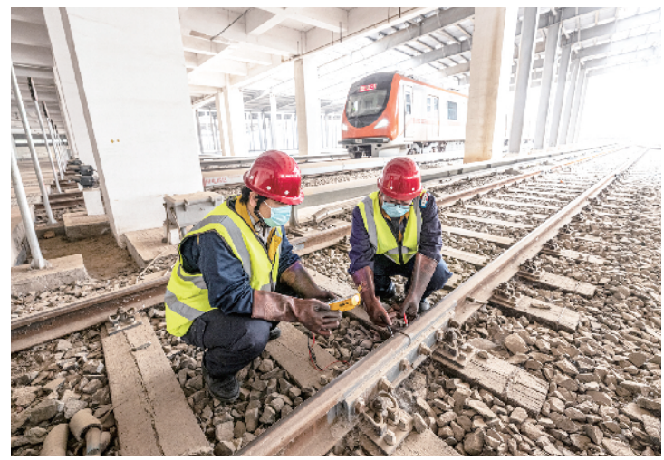
运行人员检查区间走行轨绝缘节的性能
