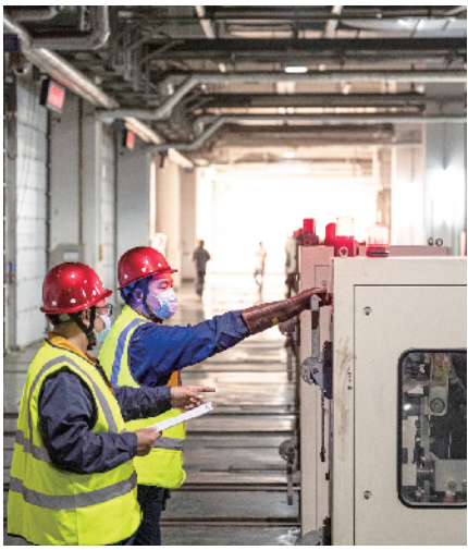
运检人员检查电源的控制开关
