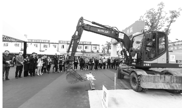
中国海员建设工会劳动和技能竞赛推进会走进中建二局三公司项目工地
