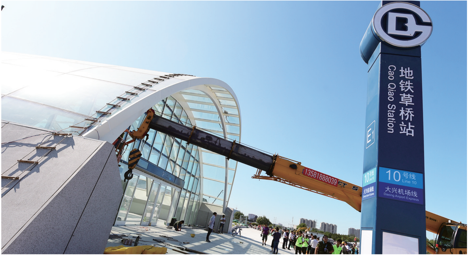
大兴机场线草桥站外观基本完成，工人正在进行室内装修。
