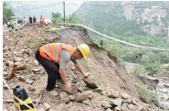
大雨中, 道路路基被冲断, 50米长的道路整体塌陷下去。
