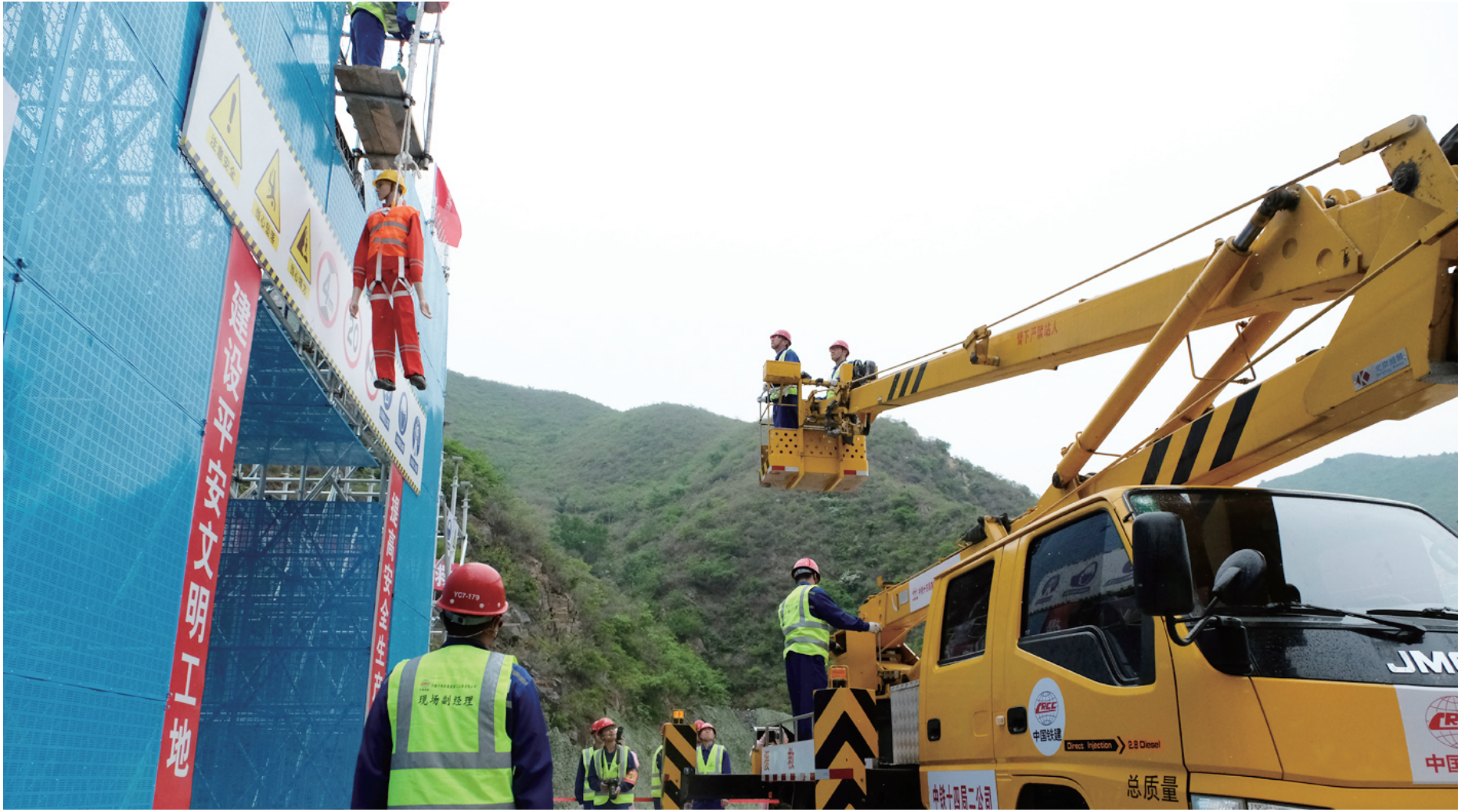
施工人员高处作业坠落，立即调用高空升降车实施救援。
