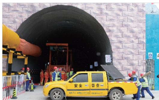
隧道坍塌后，救援队迅速到达事故现场。
