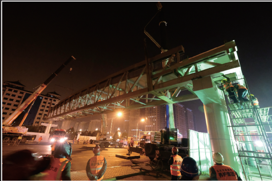
凌晨4时40分,东单路口南全新的47.5米铝合金桁架结构主梁整体稳稳的架在了桥墩上。
