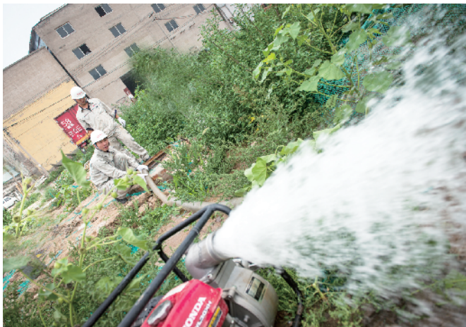
因近日雨水量大，井内积水较多，班组成员及时抽出井内积水。
