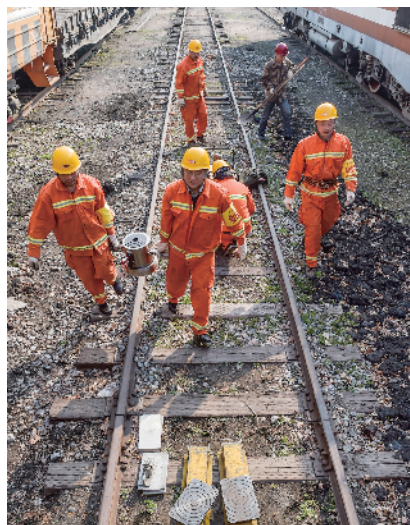
班组成员先用起复设备将车辆移至钢轨之外，模拟列车行车造成整车脱轨的事故。
