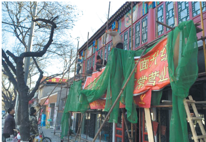
今年年初，簋街环境综合提升工程第一阶段各项任务基本完成。
