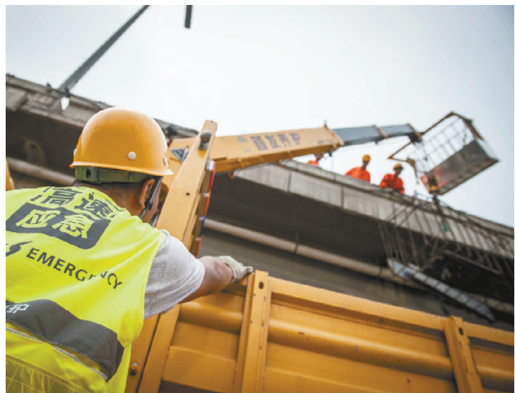
▲在立交桥路段出现损坏桥面，要用起吊车才能检修，保障队员维修操作安全。
