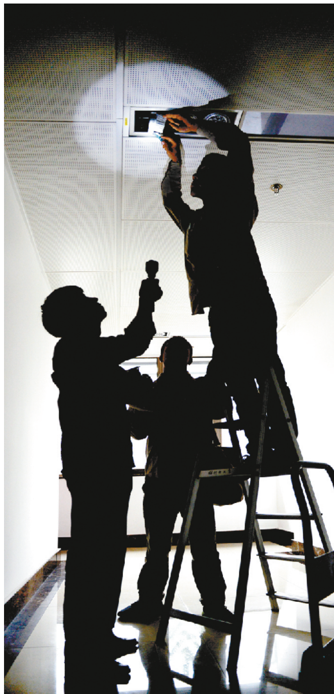
师徒三人组合撑起整个大厦的电网运转。
