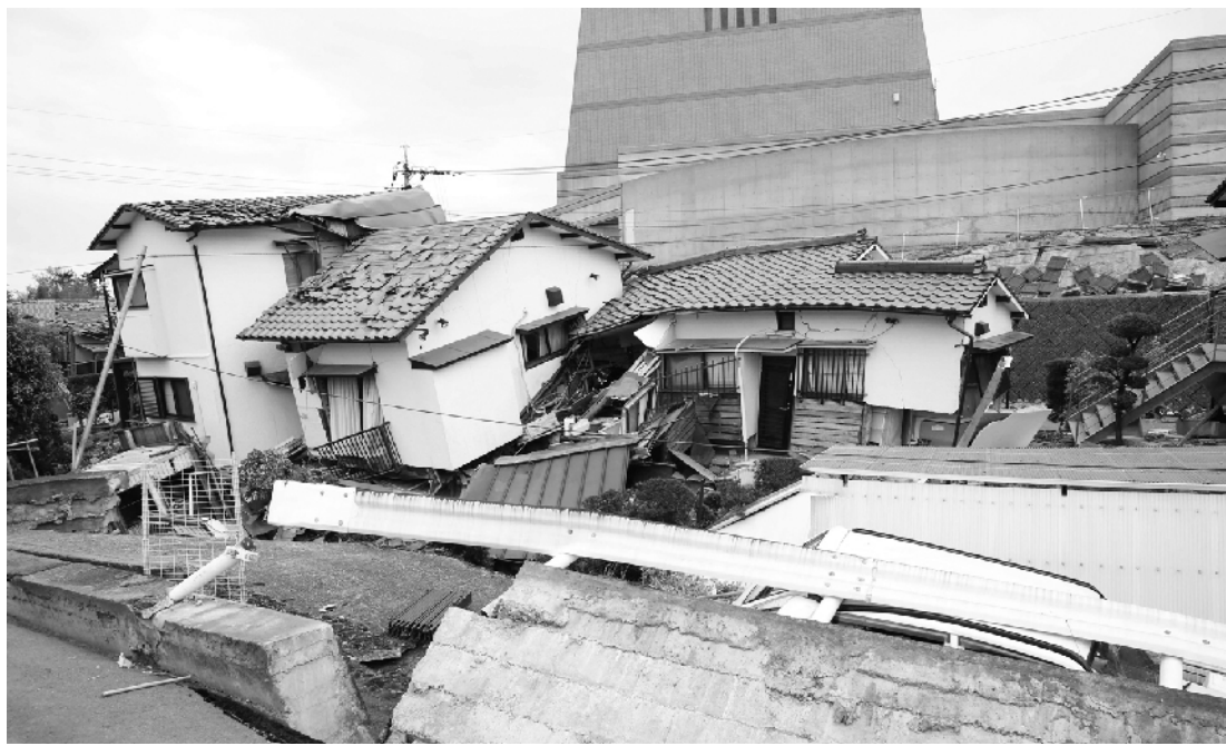
图为4月16日在日本九州熊本县益城町拍摄的被地震损坏的房屋。
